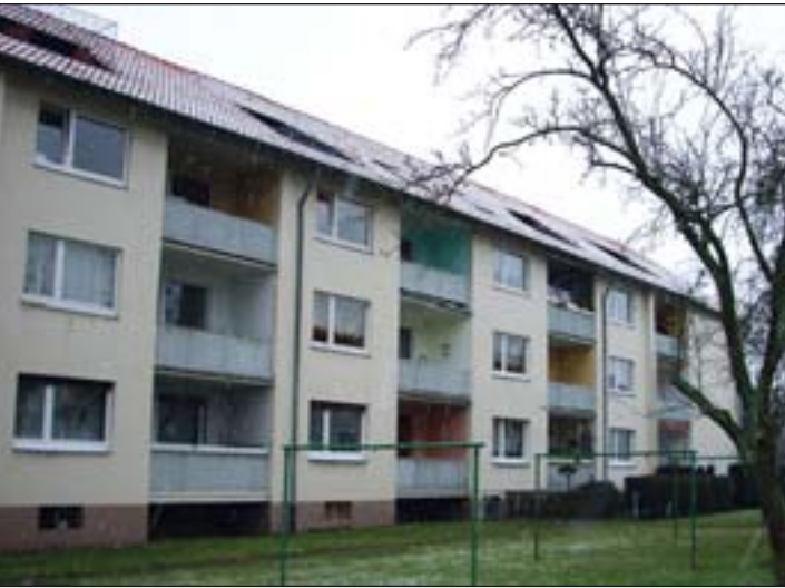
▲ Die Putzfassade dieses Wohngebäudes in Bielefeld zeigte deutliche Risse und Abplatzungen. Nach der Sanierung strahlt die neue Klinkerfassade in einem warmen Rot-Ton.
